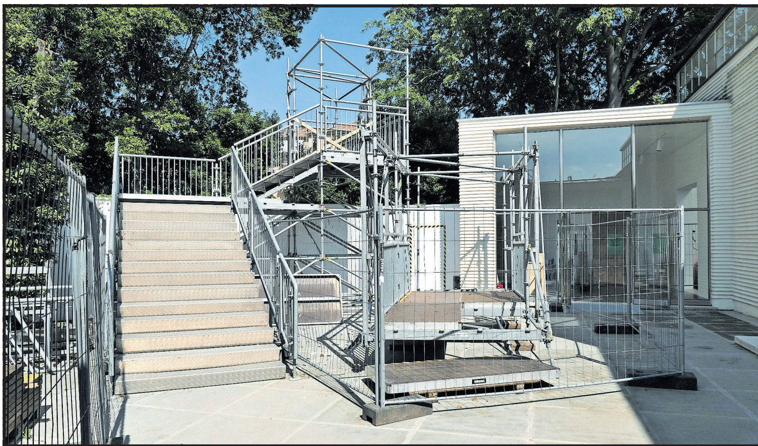
Corpus Delicti: Die Teile der Brückenkonstruktion wurden wie bei einer plötzlich eingestellten Baustelle zurückgelassen.
